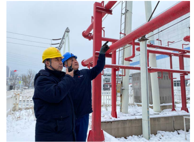
检查启备变运转情况
