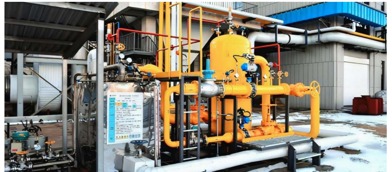
国电电力积极推动燃煤耦合生物质发电技术示范应用，支撑煤电低碳化发展
